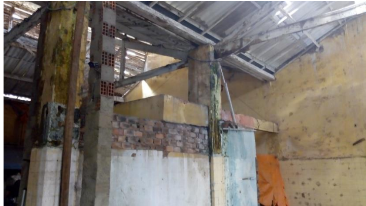
Figura 41 - Estrutura Deteriorada Mercado de Cereais
